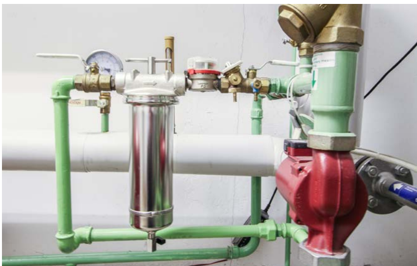
Buaers filterenhet installeras i returledningen i en separat bypasslinga.
