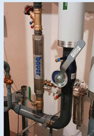
Bauer-laite asennettuna lämmityskierto.
