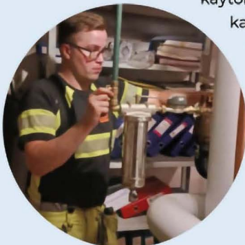
Mikko pannuhuoneessa Bauer-suodatinta vaihtamassa.
