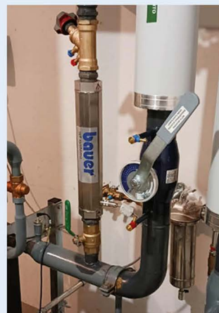
Bauer-anläggningen installerad i värmenätet.
