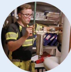
Mikko är i värmefördelningsrum och byter filter.
